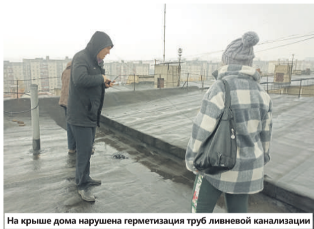
На крыше дома нарушена герметизация труб ливневой канализации
